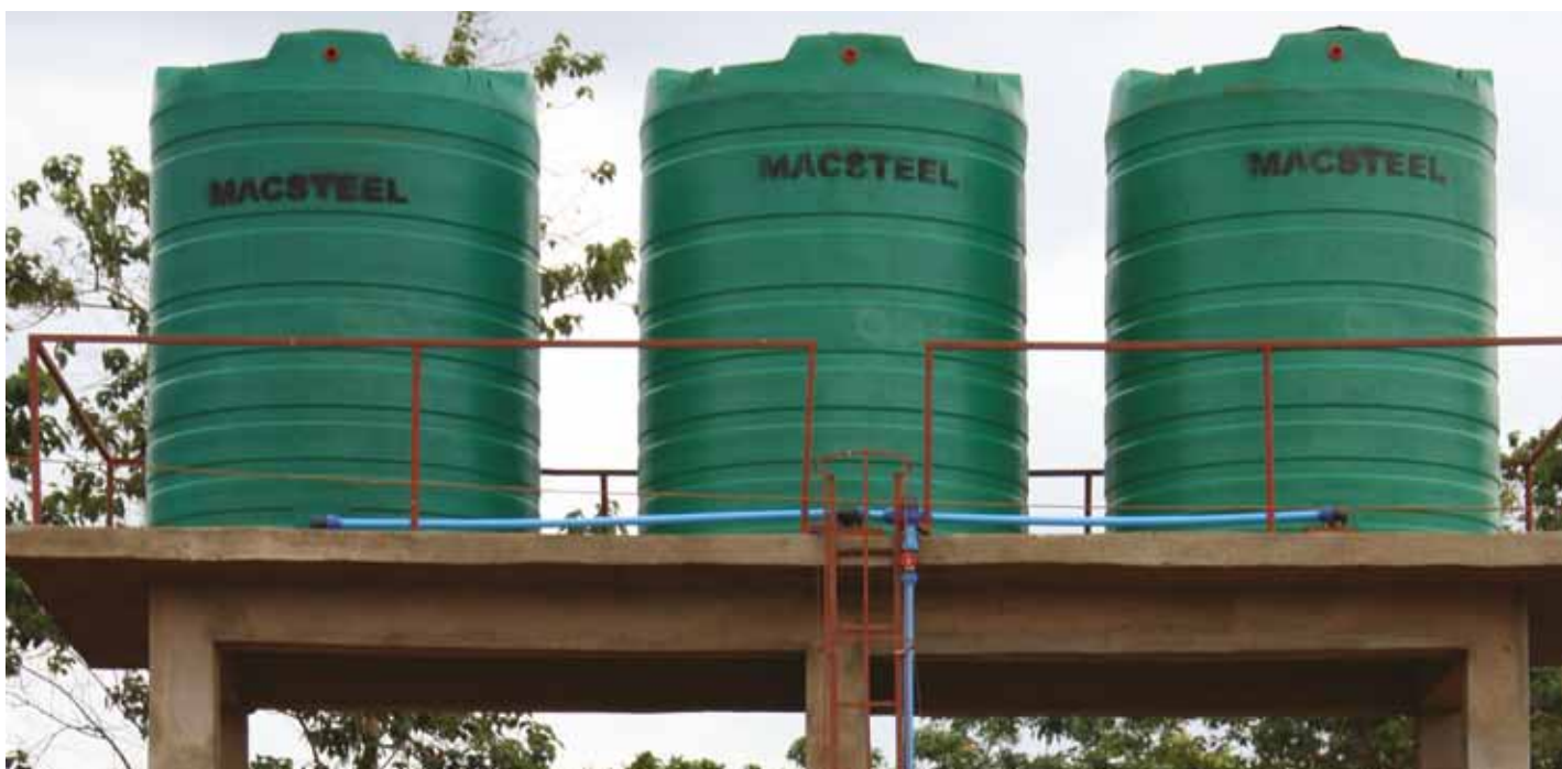
Neue Wassertanks versorgen die Wohnhäuser mit frischem Wasser
